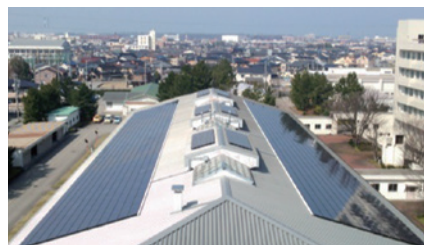
図1 工業試験場の太陽光発電システム
