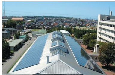
図1 実験棟屋根に設置された太陽光発電システム
